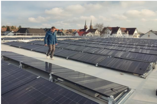
PV-Anlage auf der Schwarzbachhalle
